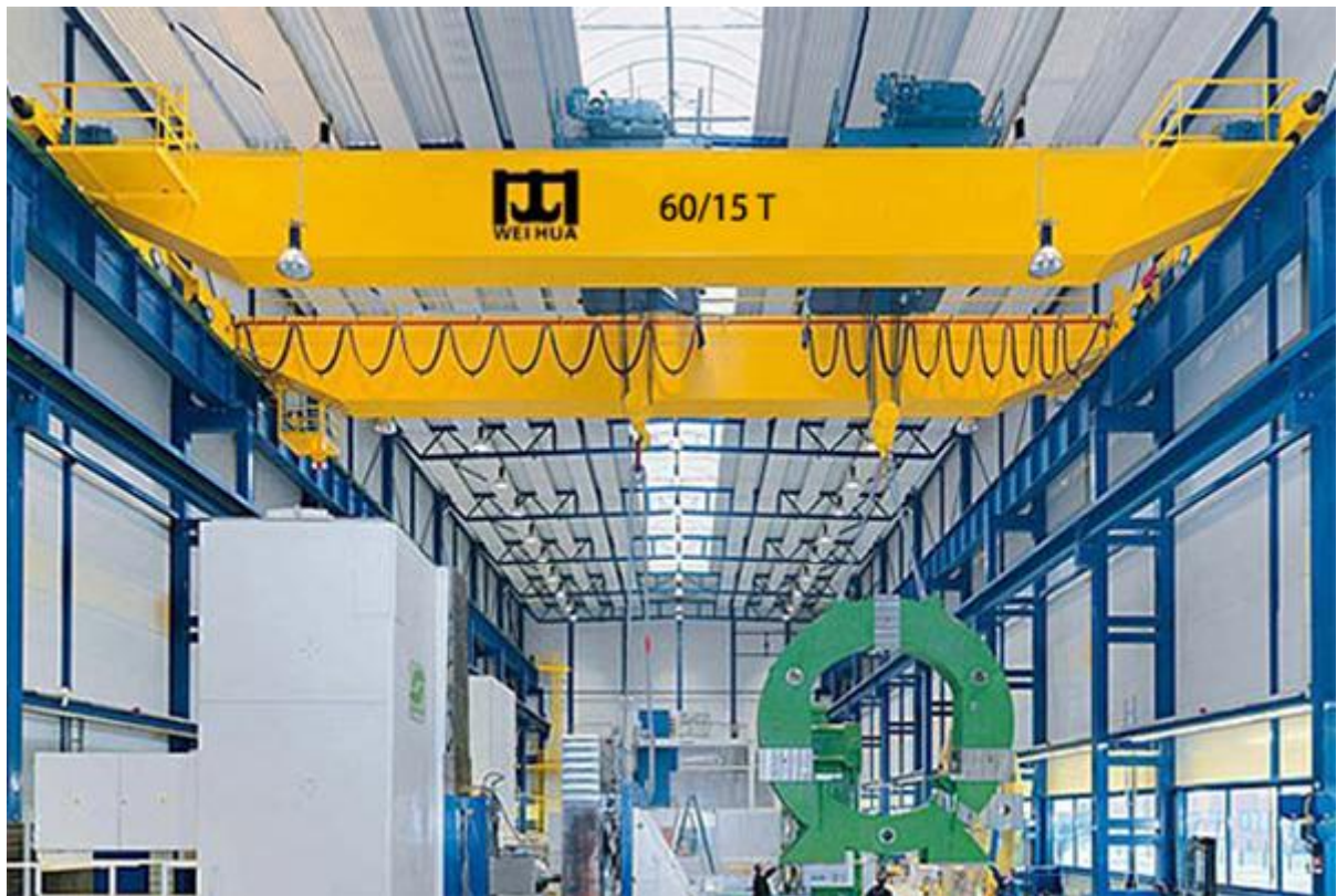
Grúa puente de 60 toneladas
