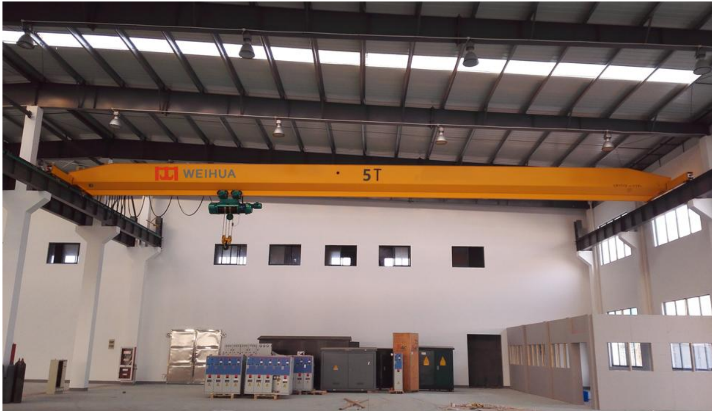
Puente grúa para almacén
